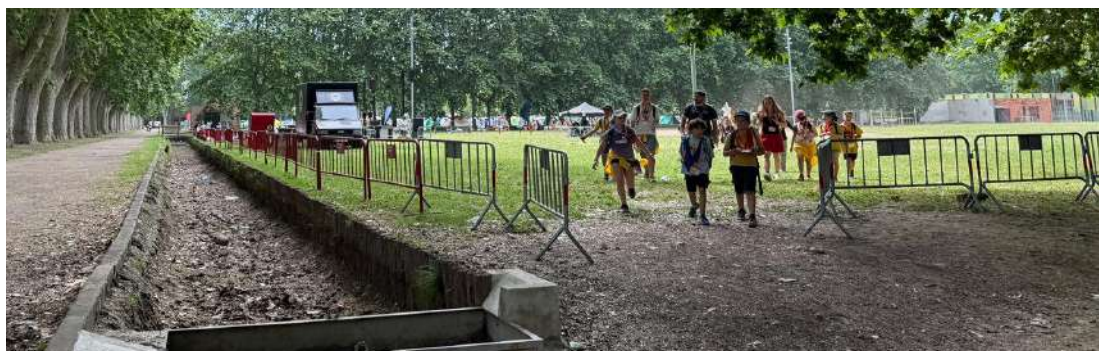
Fotografia on s'observa que es va tallar el canal d'aigua. 1-6-2025.
