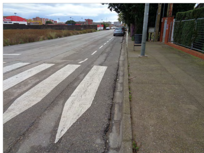
Vorera estreta i sense pas de vianants adaptat
