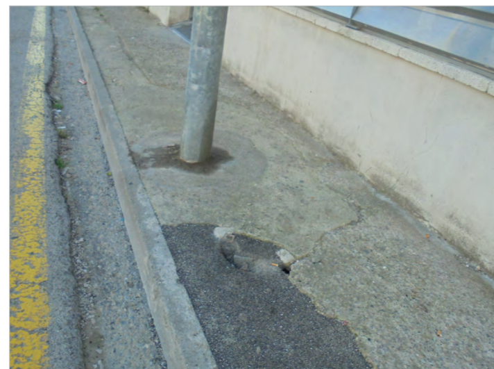
Paviment de vorera en mal estat
