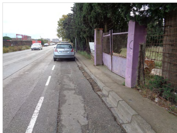
Vorera molt estreta i sense pavimentar
